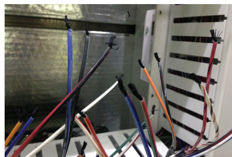
Figure 3. Cables corroídos en el interior de un gabinete por problemas de condensación y corrosión.
