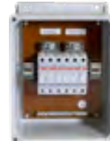
RF-2-3, 4, 6 Cajas combinadas sin conexión a tierra
