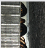
Daño en el serpentín
